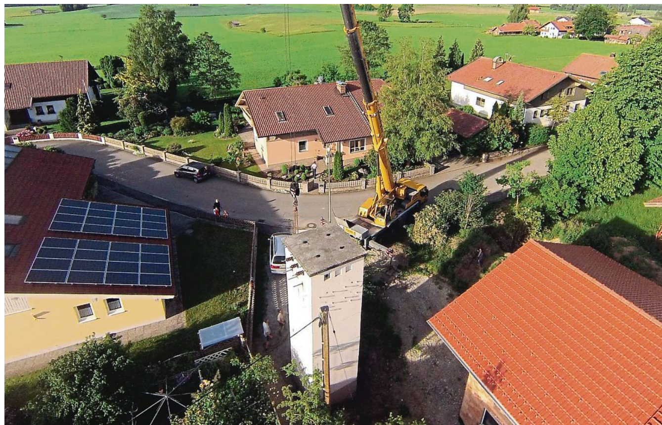
Schwerst- und Millimeterarbeit: Mittels Schwerkran ist der frühere Trafoturm an der Bahnhofstraße in Schwabbruck ab- und an der Dorfstraße bei Gerald Siegl's neuem Haus wieder aufgebaut worden. FOTOS: HEROLD
