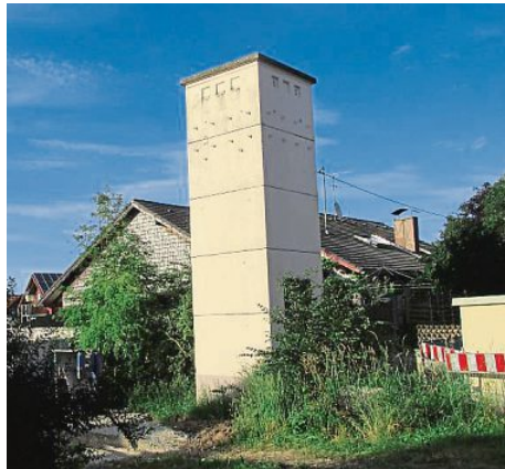
Der Trafo-Turm steht derzeit noch an der Schwabbrucker Bahnhofstraße.
